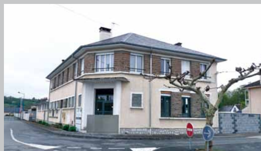
L'Arrayade, futur local de la crèche de Pontacq, en cours de travaux
